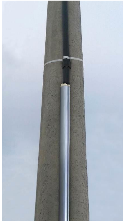
Foto ilustrativa 01 dos anexos W, Y, AA, BB, CC, DD e EE – Detalhe do eletroduto junto ao poste
